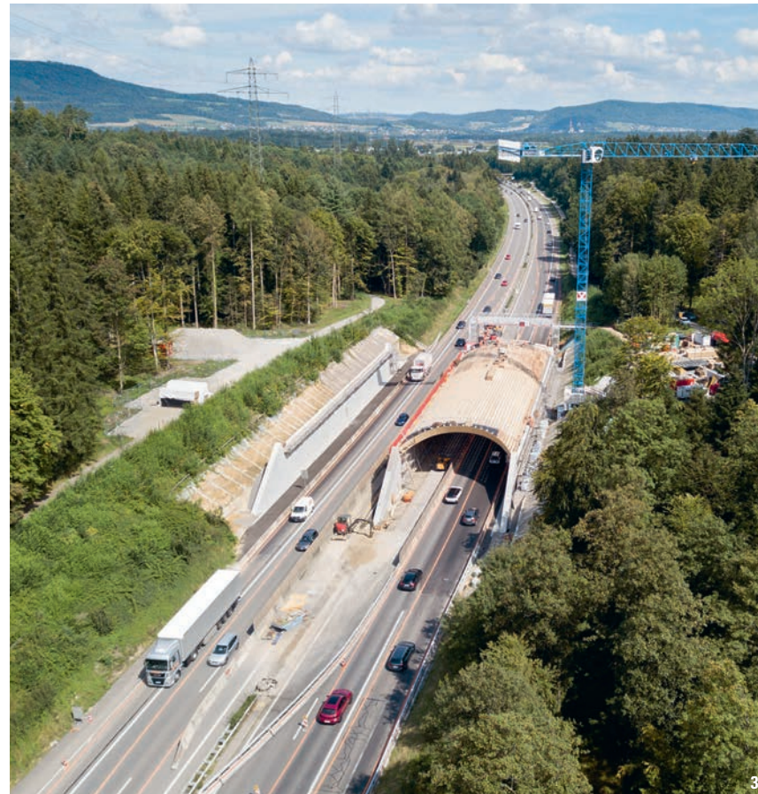
3 Montage des Holztragwerks bei fliessendem Verkehr: in einer ersten Etappe das Portal über die Fahr-bahn Richtung Zürich, in einer zweiten über die Fahrbahn Richtung Bern. 4 Das Landschaftskonzept der Grünbrücke. Zu den im Wildtierkorridor AG6 Suret lebenden Zielarten zählen unter anderem Biber, Fuchs, Wiesel, Dachs, Eichhörnchen, Reh, Baumrarder, Hermelin, Iltis, Feldhase, Wildschwein und Spitzmaus.
