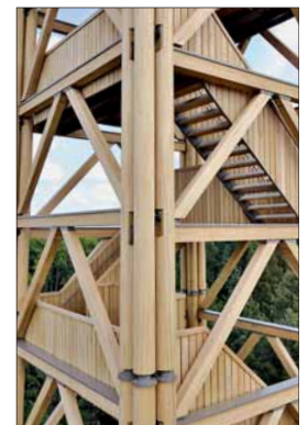
Der 2020 wiederaufgebaute Goetheturm aus Edelkastanie-BSH mit neu entwickelten Anschlussdetails soll langfristig der Witterung trotzen. Fotos: Ingenieurbüro Wirth Haker
