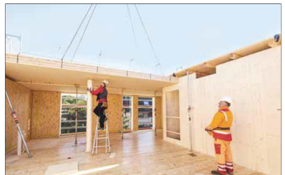
Einhang eines TS3-Brettsperrholzelements. Der Plattenstoß ist herstellereitig bereits mit Primer vorbehandelt und mit Dicht- und Segmentbändern versehen.
