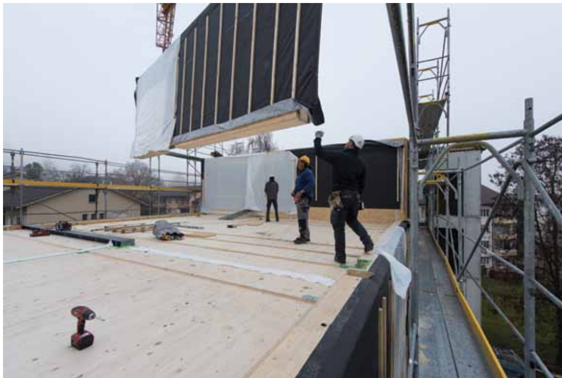
Statisch entkoppelt: Der Aufzugsschacht (rechts) steht schon, bevor der vorfabrizierte Holzbau aufgestellt wird. Als nächstes werden die Betonstützen davor gesetzt werden und erst zum Schluß die Laubgänge und Terrassen in Ortbeton gegossen
