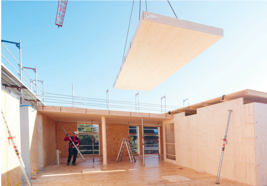
Die vorgefertigten Decken sind schnell versetzt. Die Fugen werden von Spezialisten verklebt.
