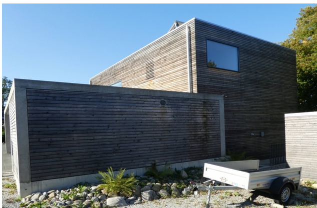
Façade après 5 ans
