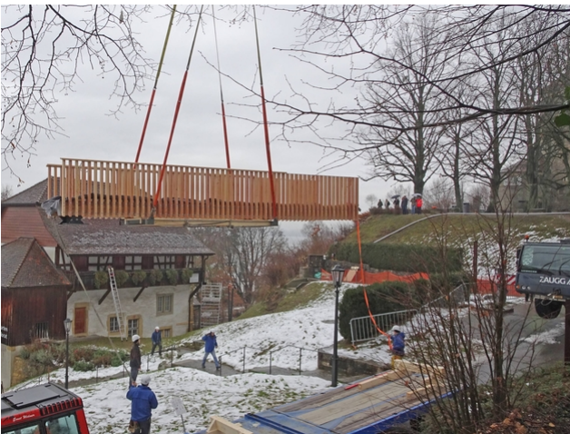
Une grue a soulevé le pont de 10,5 mètres de long jusqu'au bon endroit
