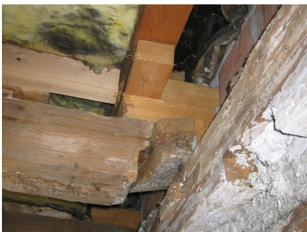
Support de poutres OG avant la rénovation
