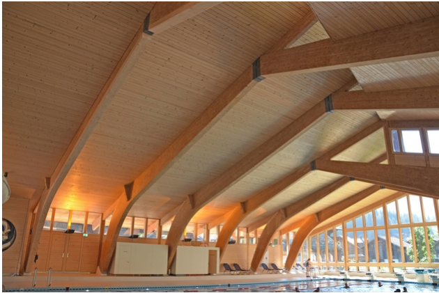
Der Träger ganz links ist mit Lamellen zusätzlich verstärkt
